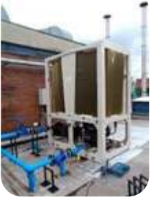
Evidencia de ejecución del proyecto PL-377. Chiller de 51 TR y 103 TR
