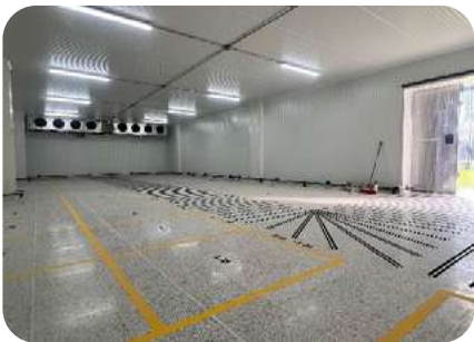
Imagen 9. Evidencia de ejecución del proyecto PL-396. Cuarto frío aftosa
