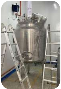
Evidencia de ejecución del proyecto PL-379. Tanque de preparación y esterilización de gel hidróxido
