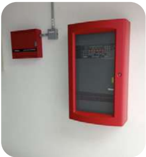
Evidencia de ejecución del proyecto. PL-53. Detección de Incendios
