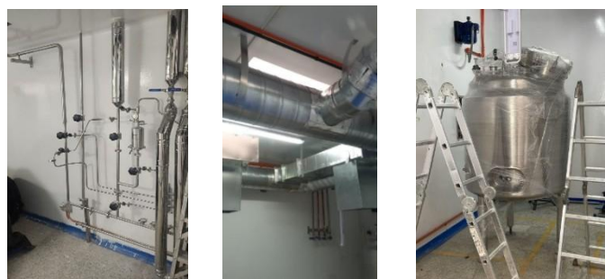
Planta preparación Gel Hidróxido
